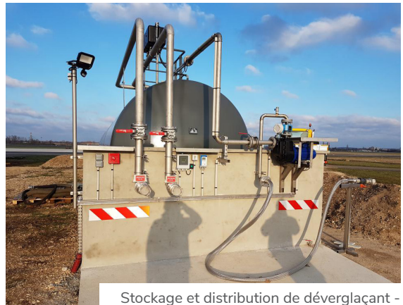
Stockage et distribution de déverglaçant - Base aérienne de Saint-Dizier
